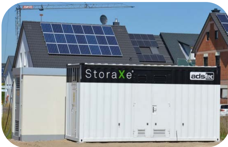
Abbildung 40 Quartierspeicher in Groß-Umstadt
