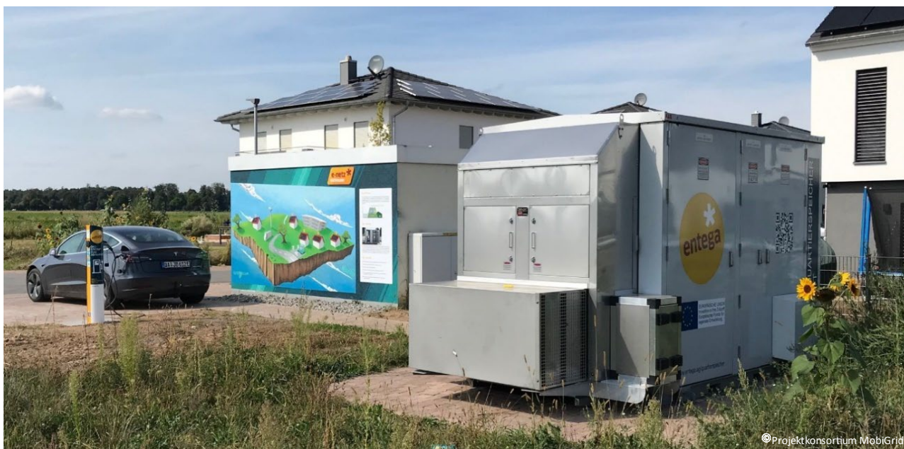
Abbildung 11: stationäre Ladestation, Transformatorstation und Quartierspeicher im Feldtestgebiet
