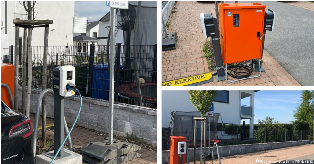
Abbildung 12: Zwei Ladestationen (Wallboxen) und ein Baustromzähler im Feldtestgebiet
