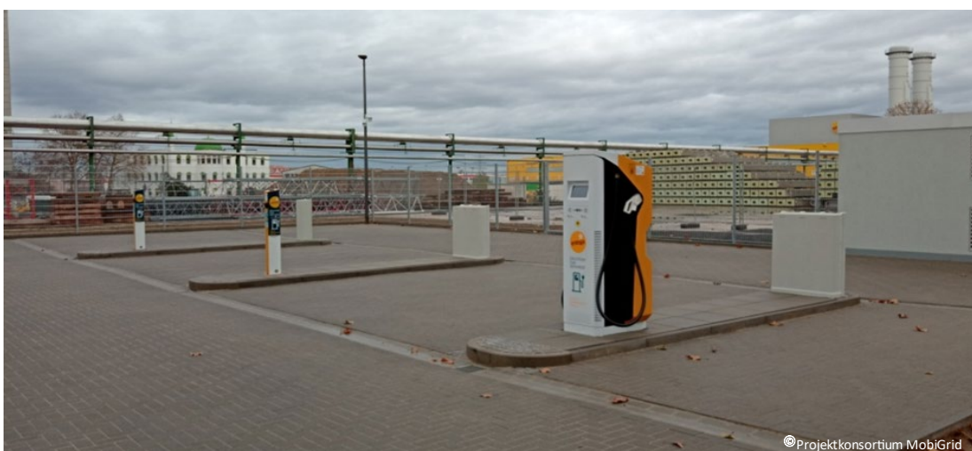
Abbildung 13: Ladepark der ENTEGA AG auf dem Grosso Gelände
